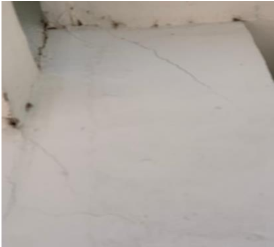
Ilustración 21 Fisura superficial en fachada izquierda
