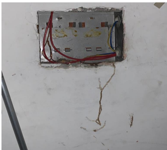
Ilustración 26 Caja eléctrica e insectos xilófagos
