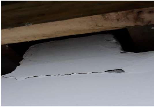
Ilustración 39 Desprendimiento del material superficial
