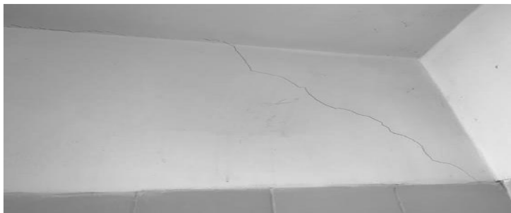
Ilustración 34 Grieta en forma de escalera baño de mujeres
