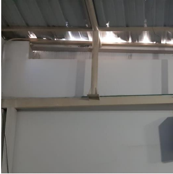
Ilustración 52 Inadecuada instalación de la cubierta
