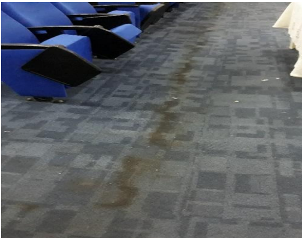
Ilustración 53 Pudrición del tapete de la sala principal
