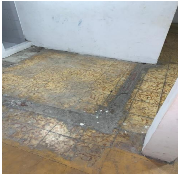
Ilustración 36 Marca de demolición
