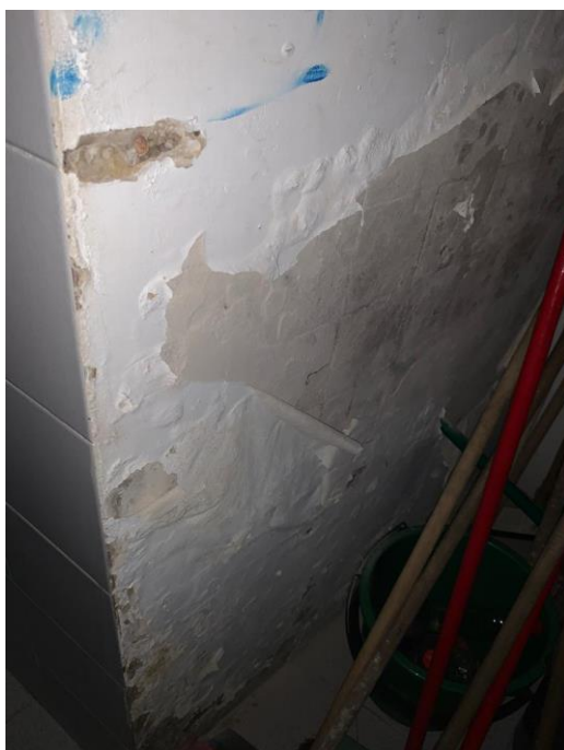
Ilustración 31 hongos y desprendimiento de pintura en pared de baño de hombres
