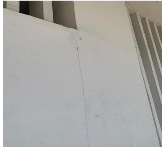
Ilustración 22 Fisura superficial fachada derecha
