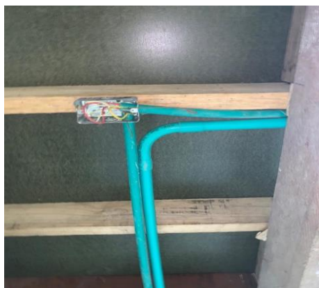
Ilustración 37 Cableado a la vista
