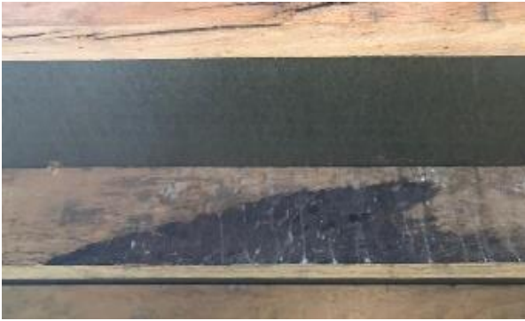
Ilustración 41 Hongos cromógenos en rastreles de madera
