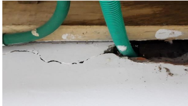
Ilustración 40 Grieta producida por la inadecuada instalación eléctrica
