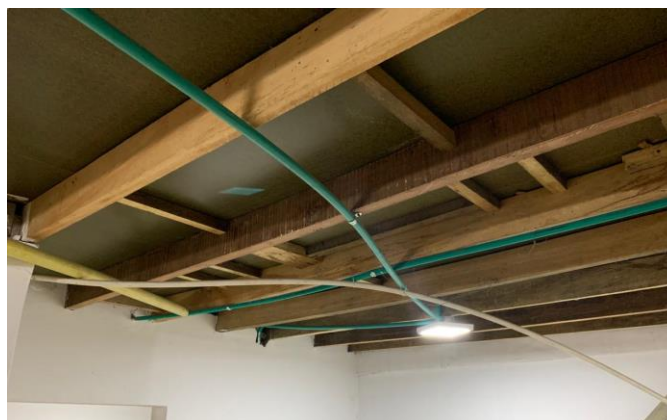
Ilustración 38 Instalación eléctrica a la vista
