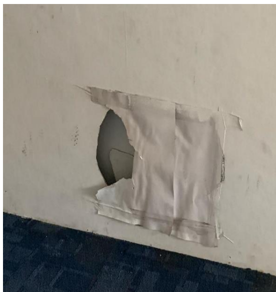
Ilustración 24 Huraco en pared falsa de drywall
