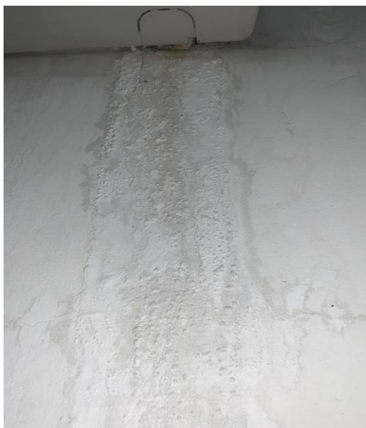
Ilustración 50 Corrosión por humedad accidental
