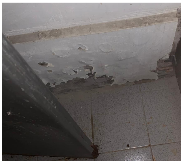
Ilustración 32 Humedad por condensación, baño de hombres
