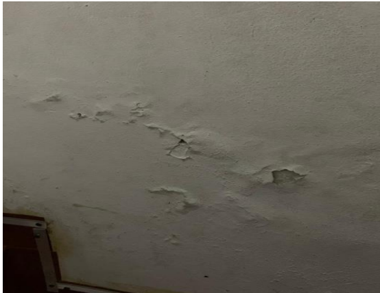
Ilustración 48 Desprendimiento de pintura en muro del escenario
