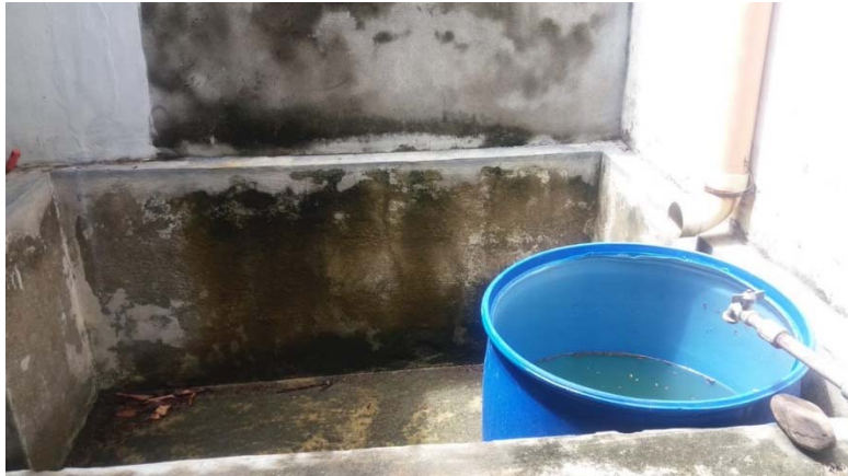
Figura 9 : Almacenamiento de agua lluvia para riego de huertas caseras. (Octubre de 2018)
