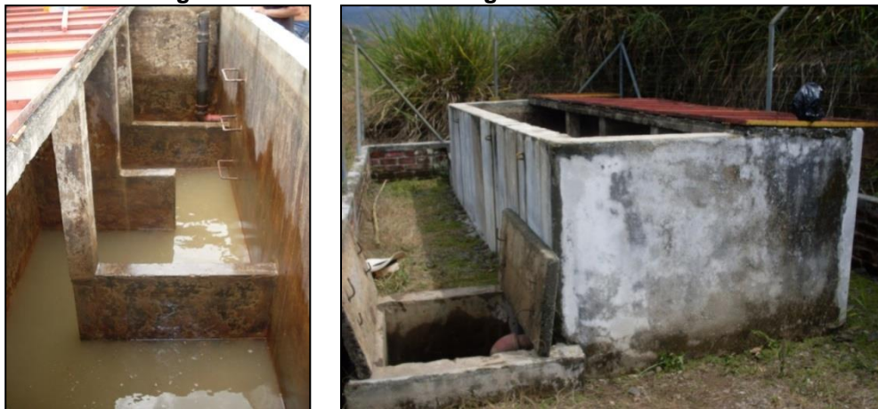
Imagen 5-13. Desarenador Antiguo en Funcionamiento
