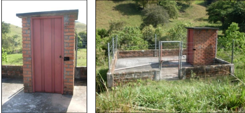
Imagen 5-18. Tanque de Almacenamiento Captación Auxiliar
