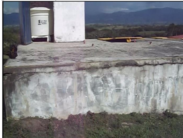
Imagen 5-21. Tanque de Cloración Hacienda La Granada
