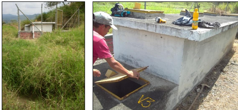
Imagen 5-14. Desarenador Nuevo en Desuso
