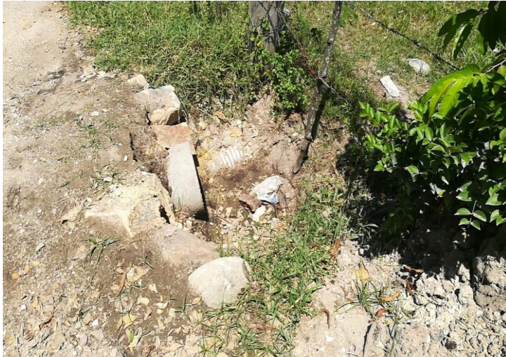
La rasante de la vía se encuentra superior a la de los predios aledaños.
