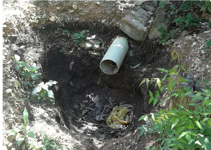
Las instalaciones empíricas de la comunidad para el sistema de evacuación de aguas lluvias afectan el alcantarillado de aguas residuales existente.
