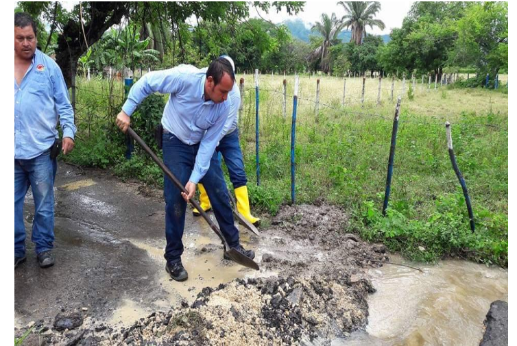
El rebose de las aguas residuales es evidente en épocas de lluvia por sus malas conexiones al alcantarillado.
