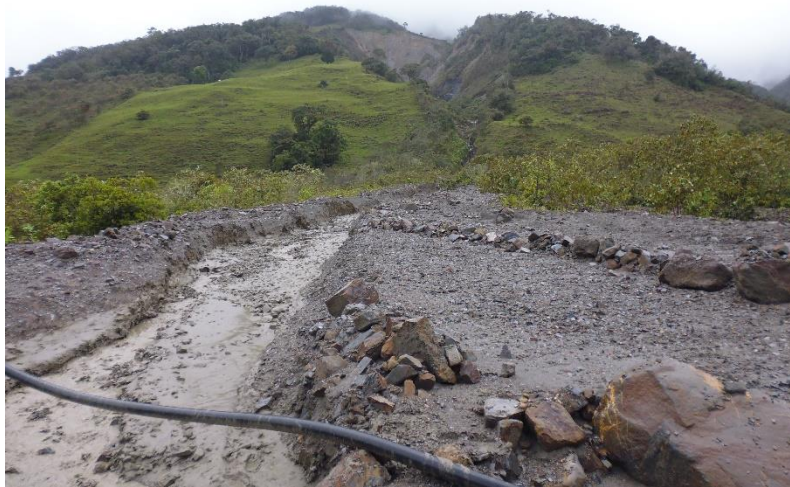
Foto No. 4: Deforestación en zona de laderas Fuente Luis Arsenio Ramos
