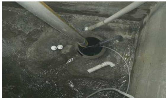
Ilustración 8. Reactor Pozo Profundo.
