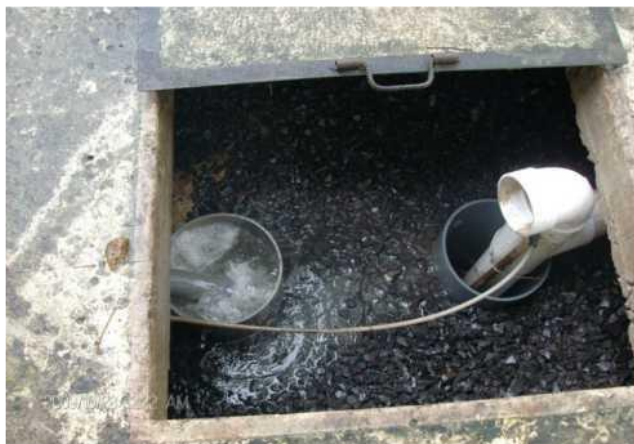
Ilustración 16. Tanque Filtro Percolador
