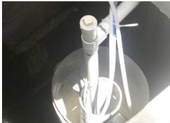
Ilustración 15. Bomba de Densidad del Reactor
