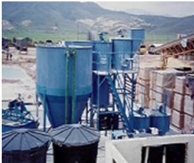
Foto 1. Sistema de sedimentación – Colcerámica -.
