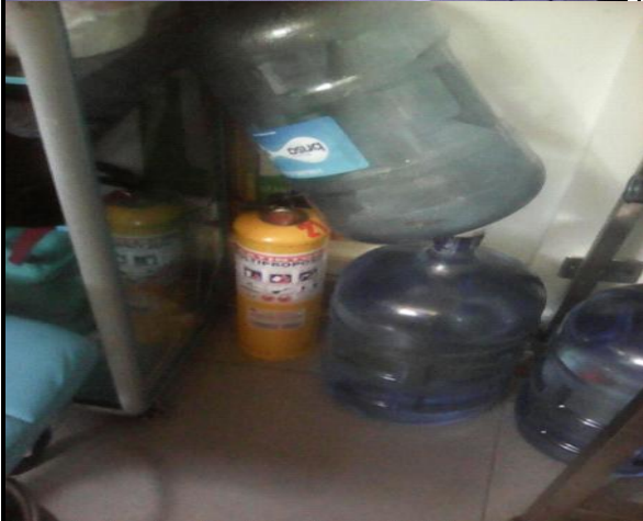
Extintor obstruido en el área de cafetería
