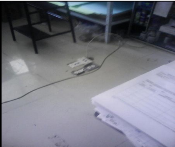
Cables expuestos en área de papelería
