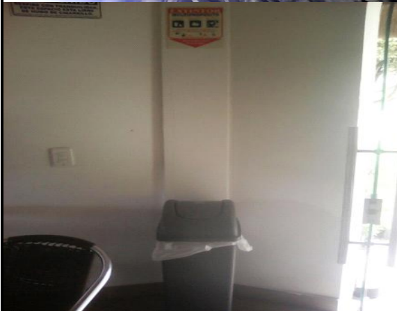
Área de extintor ocupada por caneca
