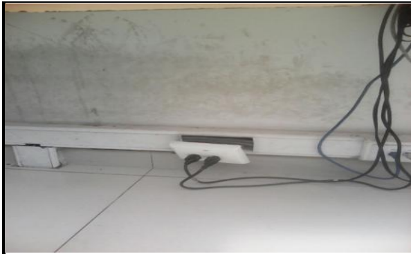
Cables expuestos tomas en mal estado
