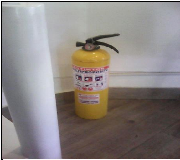
Extintor Sin manguera, ni demarcación
