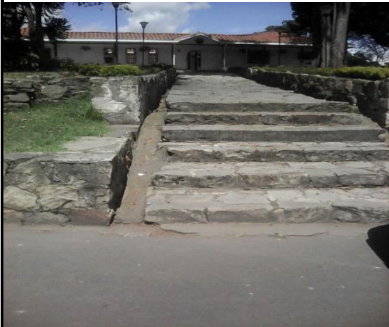
Escaleras Sin pasamanos ni antideslizantes
