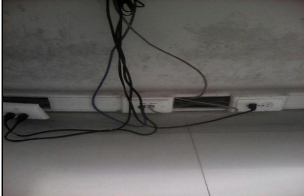
Cables expuestos tomas en mal estado
