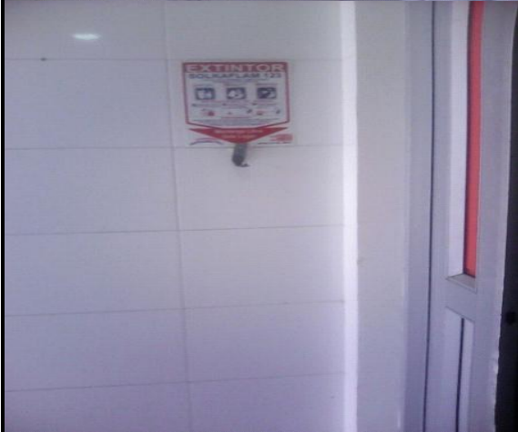
Falta de extintores en área de cocina
