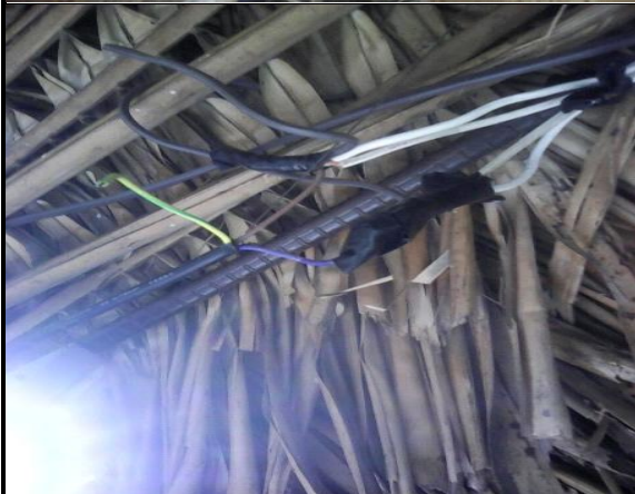
Conexiones eléctricas mal estado
