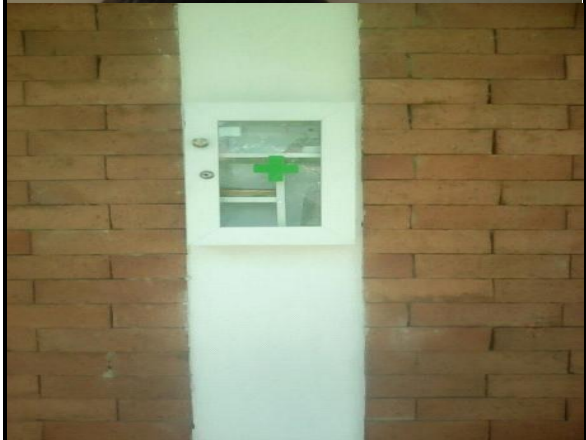
con elementos vencido y vidrio roto
