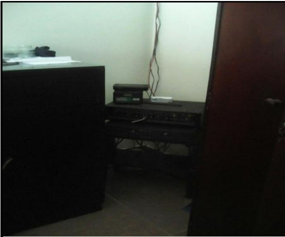
Área de riesgo eléctrico Sin extintor
