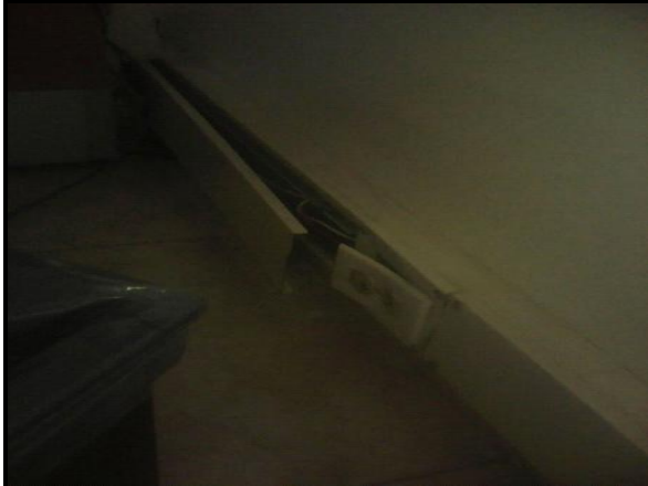
Elementos eléctricos en mal estado
