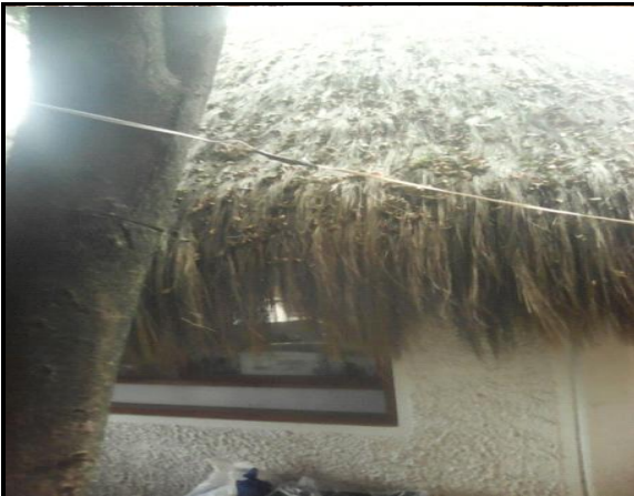
Riesgo eléctrico cable sin canaletas
