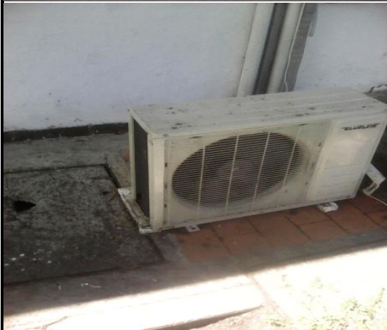
Falta extintor sin señalización ni demarcación
