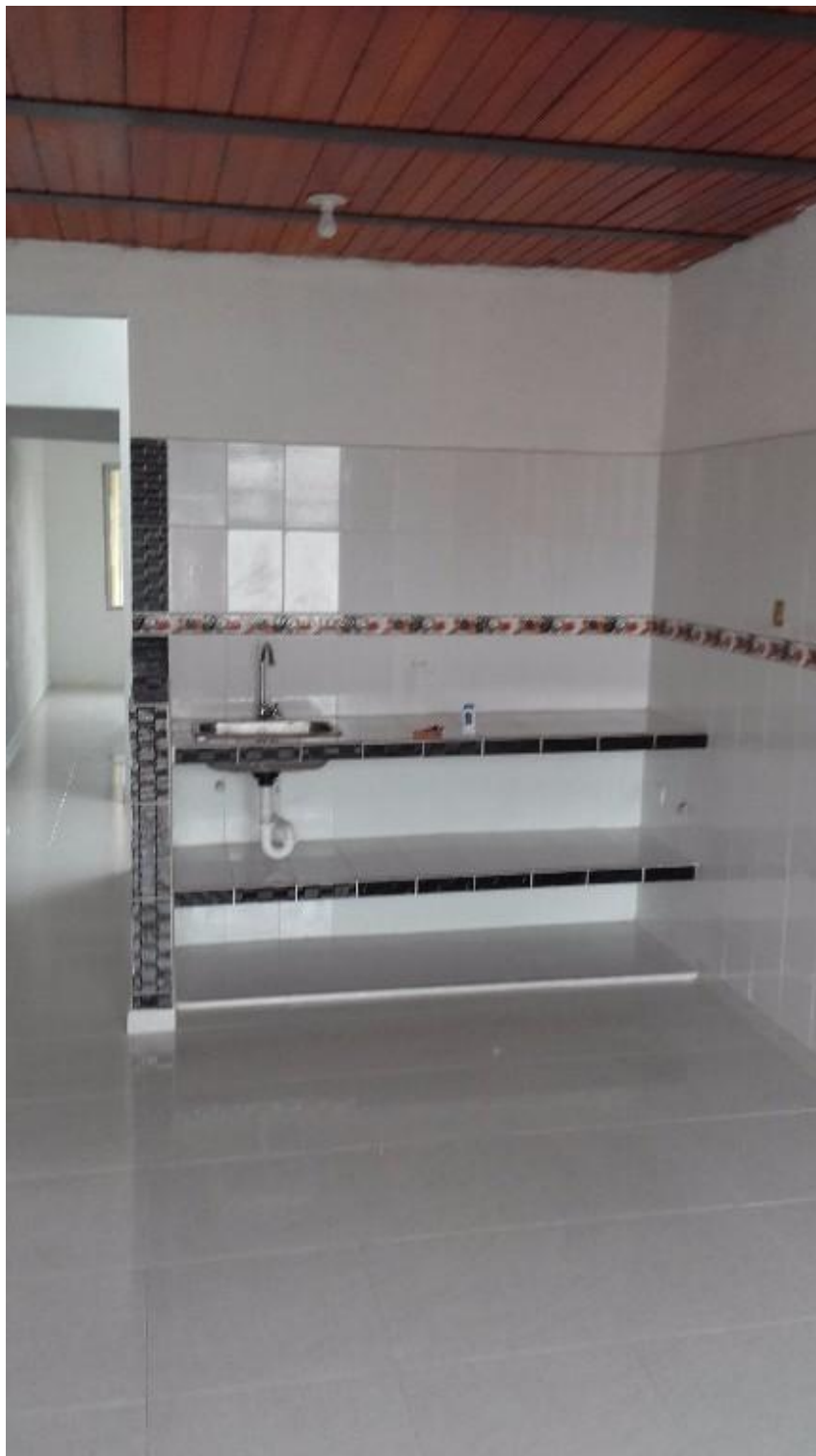
Imagen 3. Cocina no apta para discapacitados, alturas y mobiliario inadecuado. Fuente: Propia.
