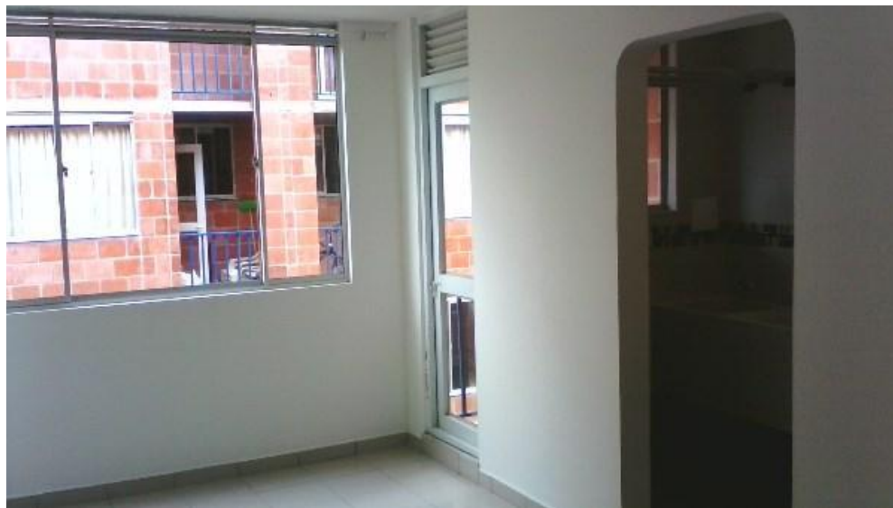
Imagen 5. Accesos estrechos. Fuente: propia.
