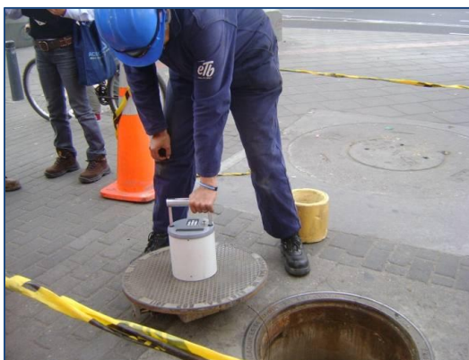
Figura 1. Trabajador sin EPP
