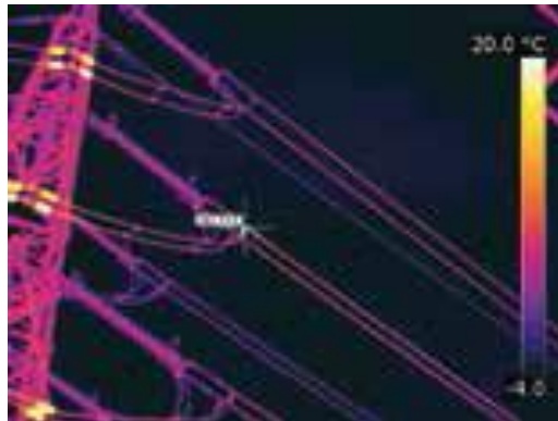
“Figura 3 y 4”, Inspecciones termografías del mantenimiento predictivo de torres eléctricas.
