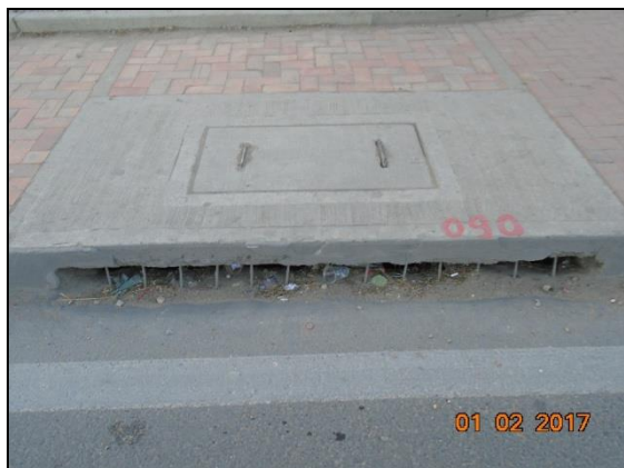
Cámara colapsada por material fino y basuras.
