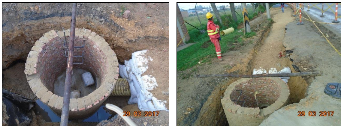
Cámara de inspección de agua residual – municipio de Mosquera Cundinamarca
