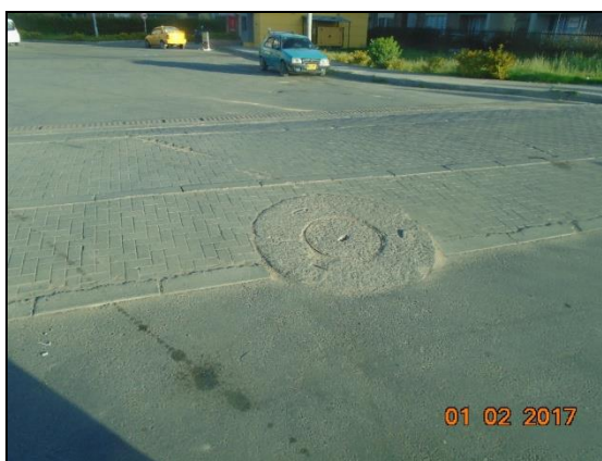
Alcantarilla en rampa no funcional.
