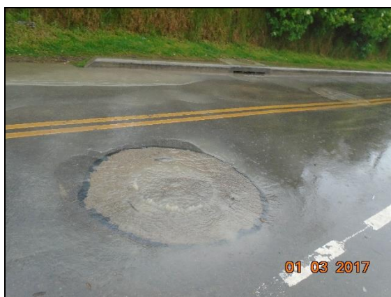
Reboce de caudal por acumulación de basuras.
