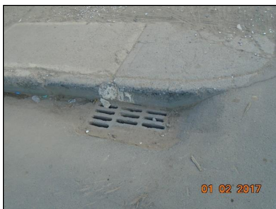
Sumidero colapsado por acumulación de material fino.
