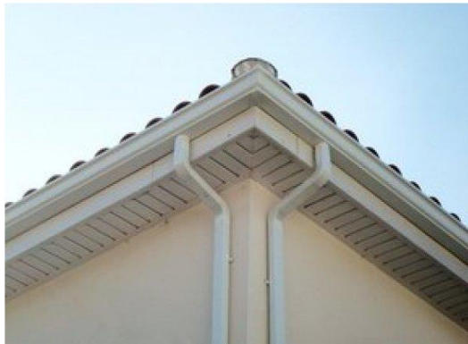
Figura 21 Bajante en PVC
