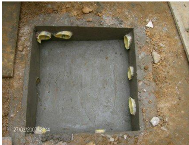
Figura 22 Cajas de inspección
