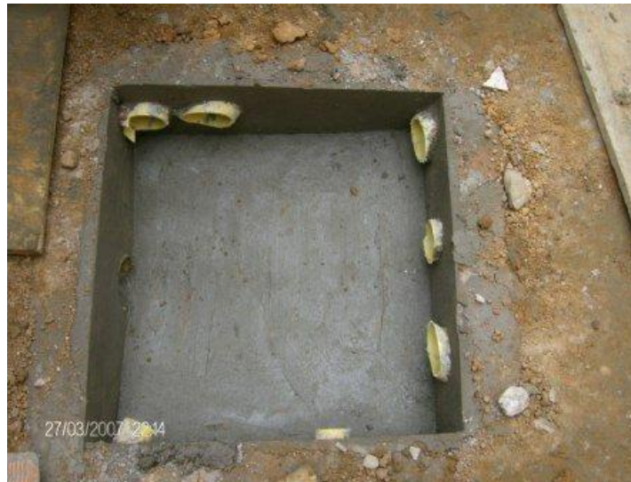
Figura 10: Caja de inspección
