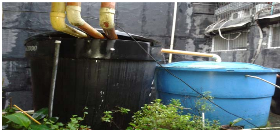
Foto 1. Tanques de Abastecimiento de Aguas Lluvias.
