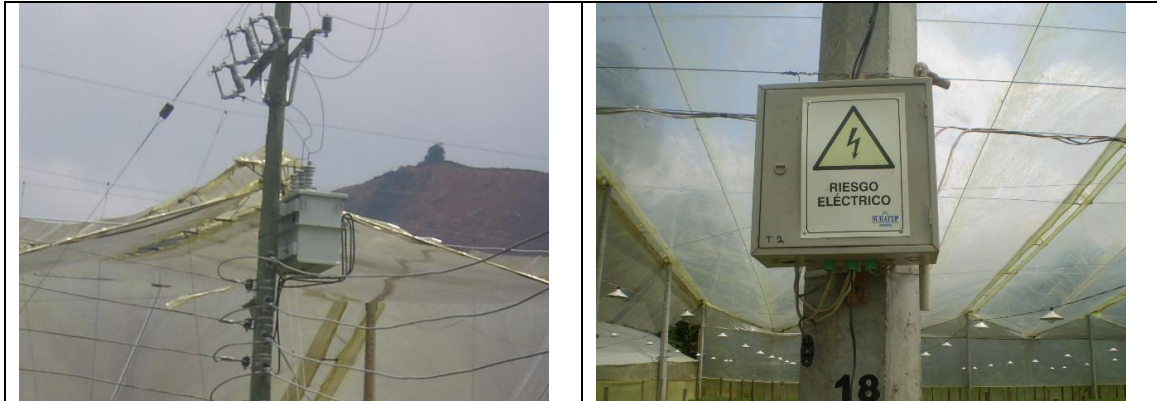
Foto 3 y Foto 4 Instalaciones eléctricas actuales
