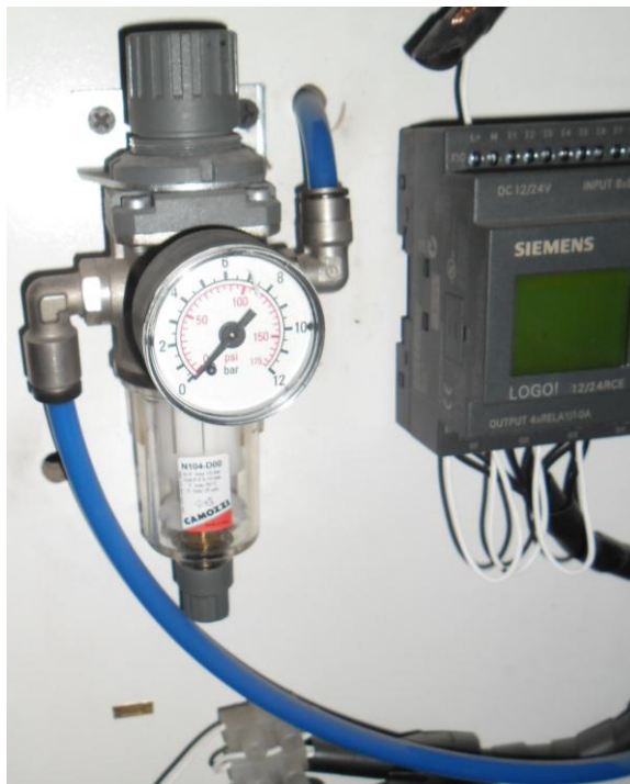
Figura 19. Unidad de mantenimiento junto al PLC.
