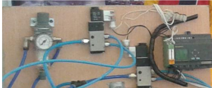
Figura 20: Electroválvulas 1 y 2 de tipo 5/2.
