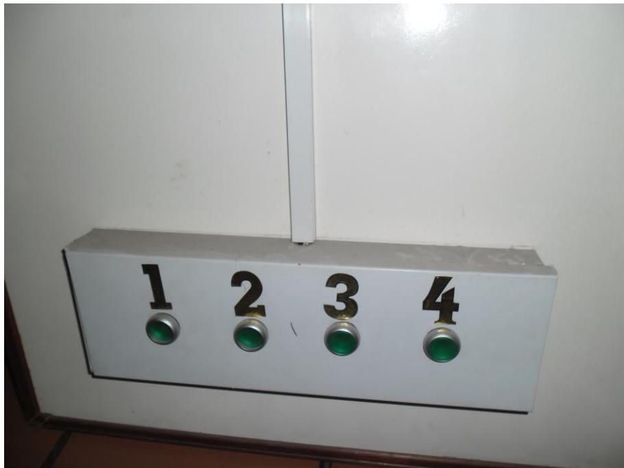
Figura 23. Contactores para proceso manual o automático.
