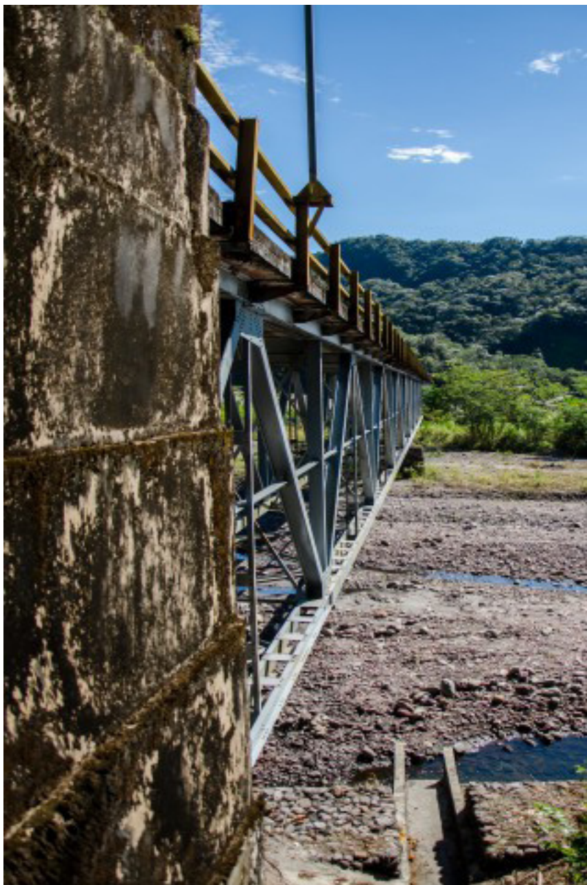
Fotografía 61: Detalle estructura, Puenete Eduardo Santos.
