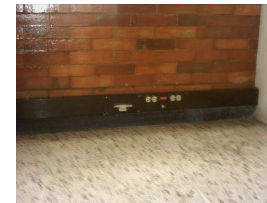
Puntos de red marcación defectuosa
