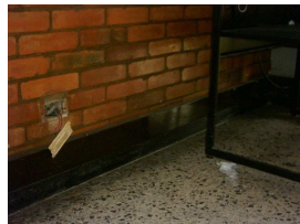
Toma corriente no regulada en regular estado
