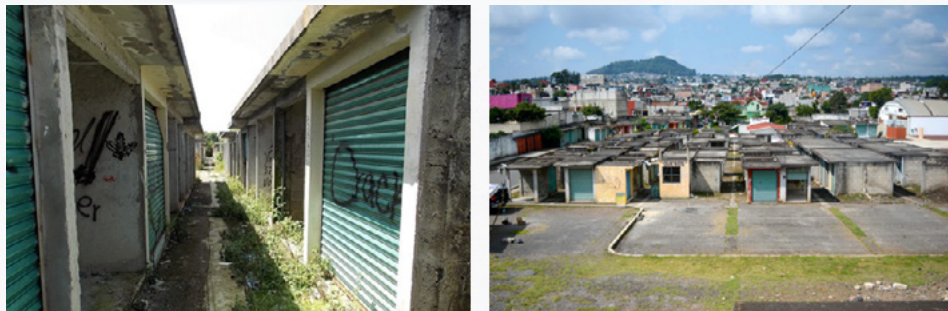
Figura 65. Tianguis de la colonia El Moral: locales en el abandono
