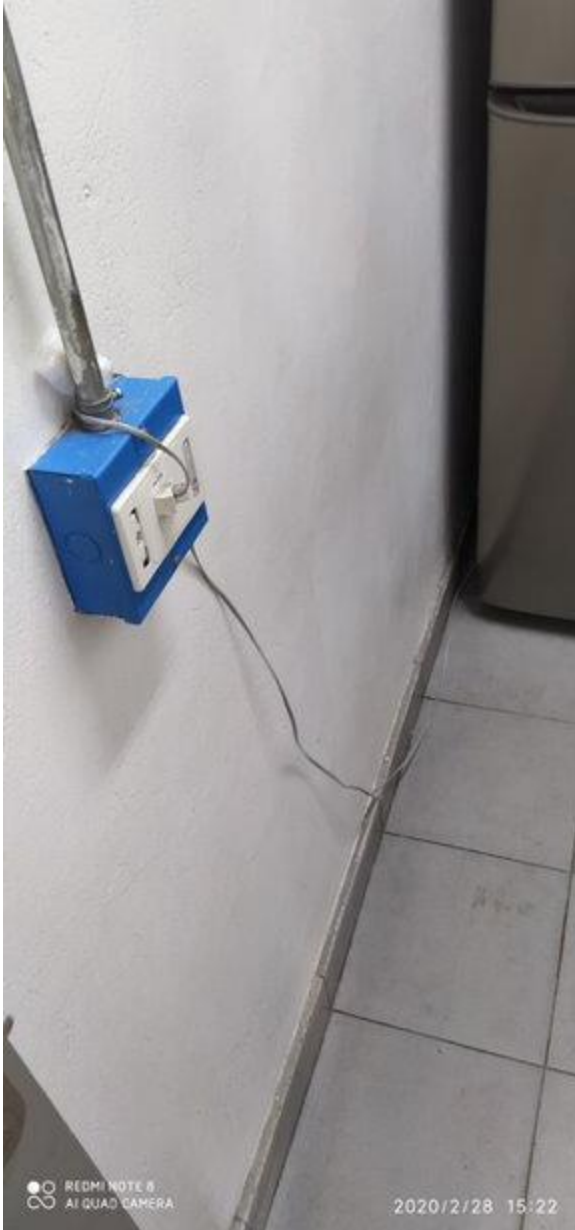
Cableado estructurado sin protección
