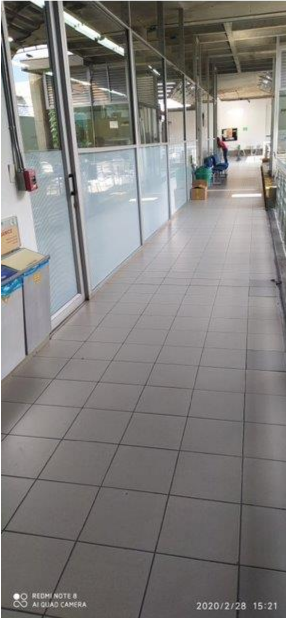
Pasillos con elementos obstructivos
