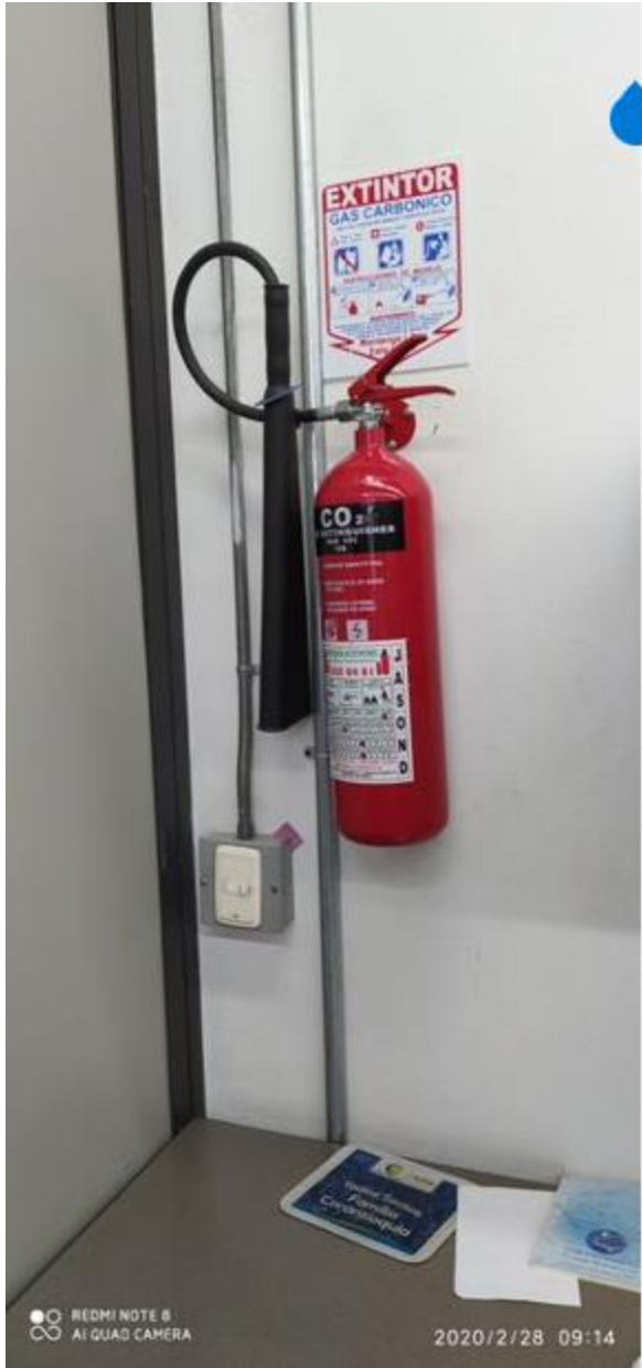
Extintores con recarga vencida
