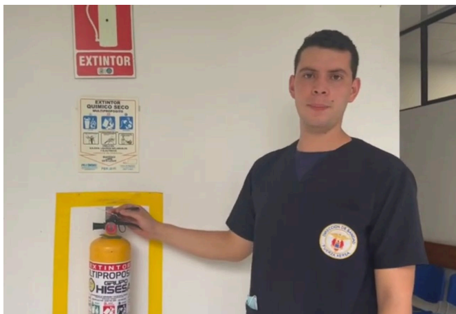
Figura 18. Revista de extintores. Elaboración propia (2022).
