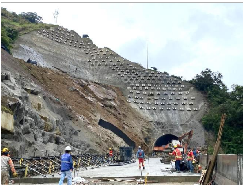
Talud Cristales K38+800 Frente La Paloma
