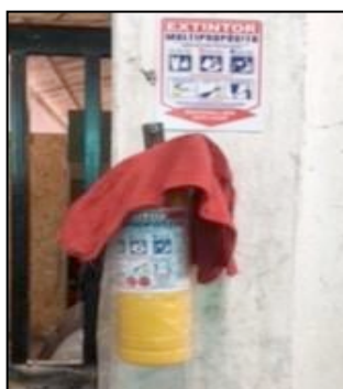
Figura I. Equipo de emergencia obstruido. Tomado de Instalaciones Hidráulicas, Sanitarias y Gas HQ S.A.S
