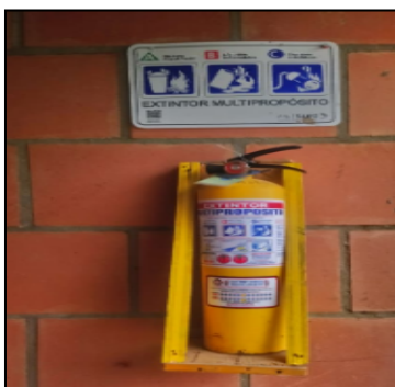
Figura J. Equipo de emergencia libre de obstáculos. Tomado de Instalaciones Hidráulicas, Sanitarias y Gas HQ S.A.S
