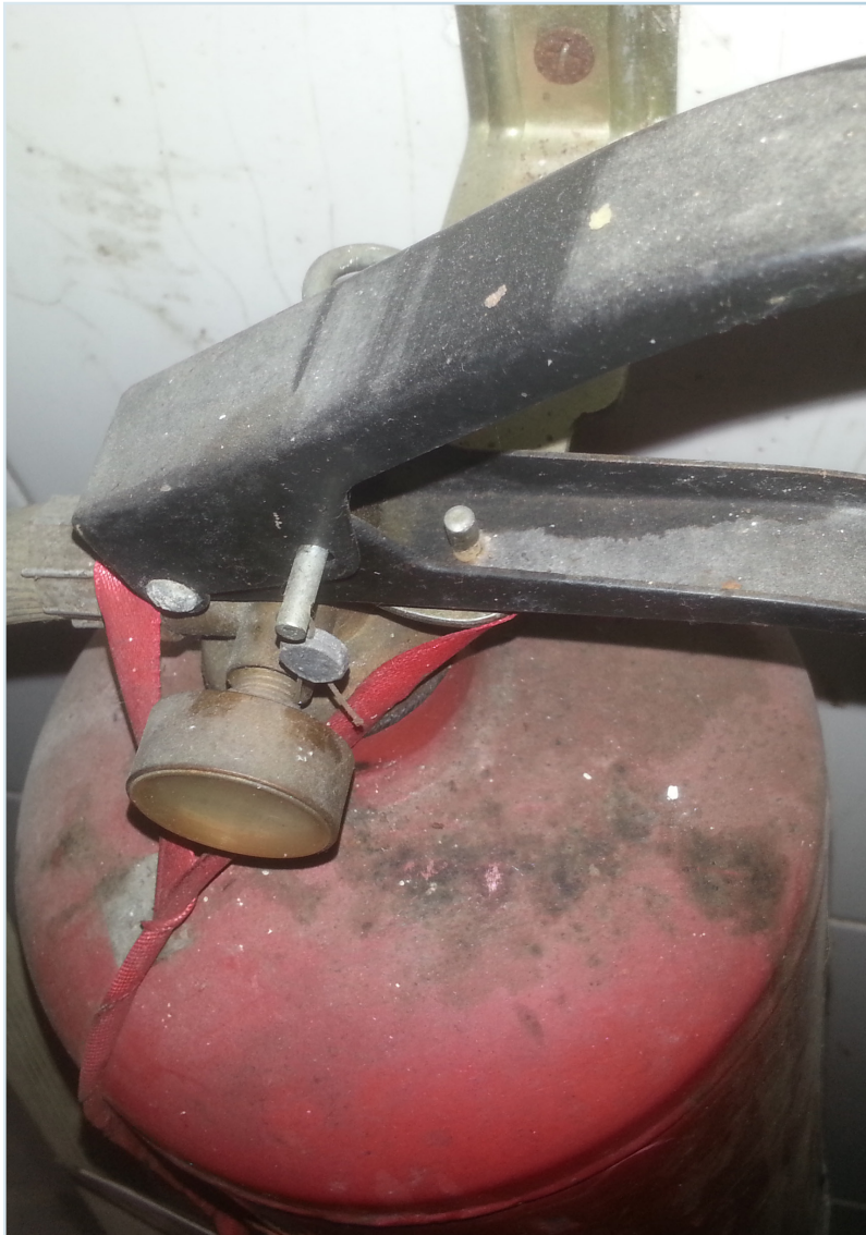
Extintores en mal estado. (Follow, www.everystockphoto.com , 2015).
