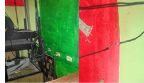
Factor de riesgo eléctrico, localidad de Los Mártires (Aguilar, UNIMINUTO Virtual y a Distancia, 2015).
