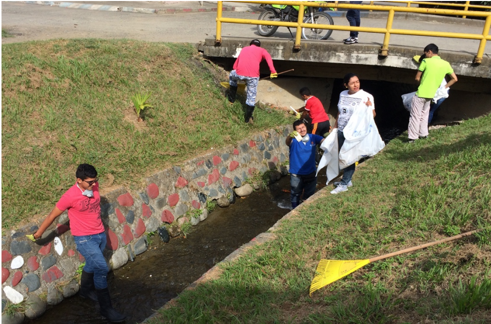
Fuente: Alcaldía de Guadalajara de Buga. 2017 – Elaboración propia. Fotografía 2: Limpieza acequia la pachita
