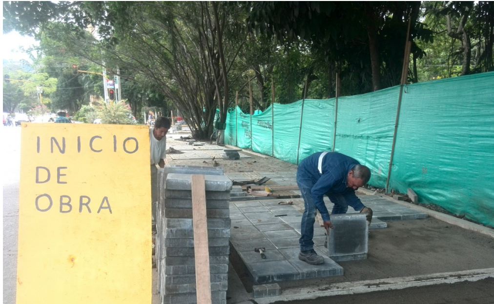
Fuente: Alcaldía de Guadalajara de Buga. 2017 – Elaboración propia. Fotografía 1: Obra parque lineal
