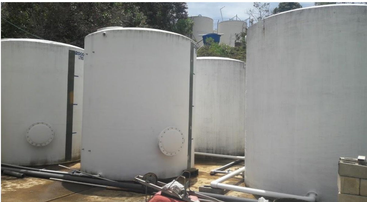
Fotografía N° 13: Reconocimiento de los tanques de Sedimentación y filtración del Acueducto Monseñor Ignacio Botero. El Santuario, Oriente Antioqueño. Fotografía de Yenifer Gómez Ramírez, Agosto del 2018.
