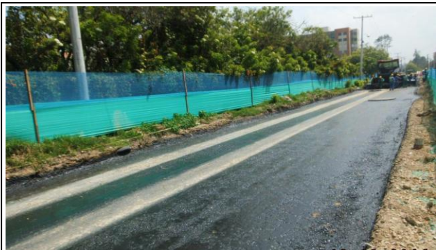
FOTOGRAFÍA N° 0005 FECHA: MAYO JORNADA DESCRIPCIÓN RIEGO AFALTICO EMULSIONADA SOBRE LA BASE DE LA VIA PARA INICIO DE COLOCACION DE CARPETA RODADURA.
