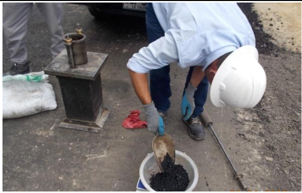
FOTOGRAFIA N° 0003 FUENTE LUIS Y CAMILO DESCRIPCIÓN SE INICIA PROCESO DE PESAJE DEL MATERIAL MEZCLADO PARA LA MUESTRA DEL LABORATORIO EN SITIO DE OBRA.
