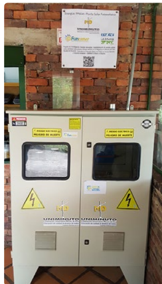
Figura 21. Sistema solar fotovoltaico funcionando
