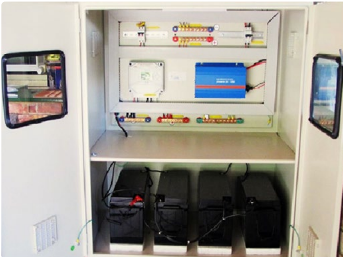
Figura 20. Componentes instalados en el armario
