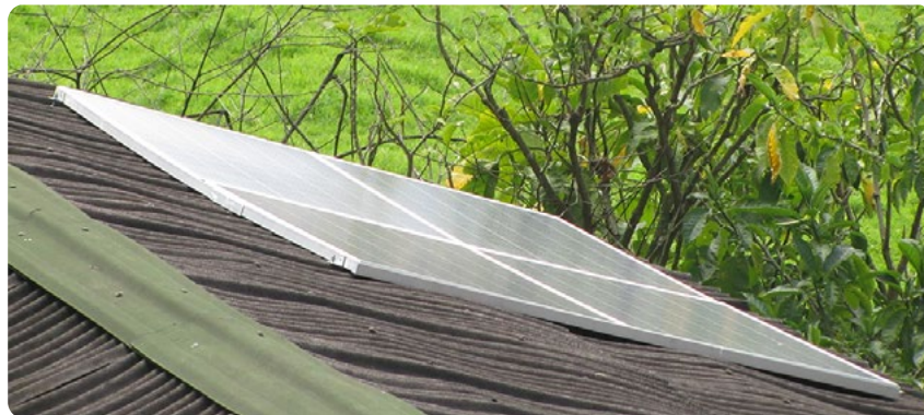
Figura 15. Paneles solares instalados sobre el techo
