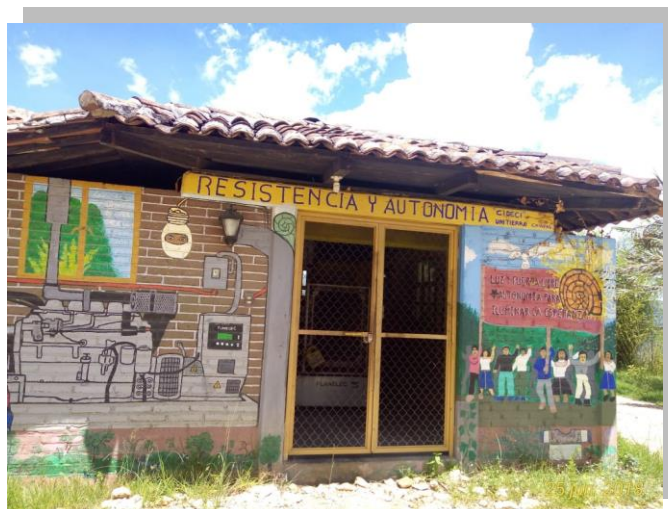
Imagen 39 CIDECI. Transformador de Energía. 2018
