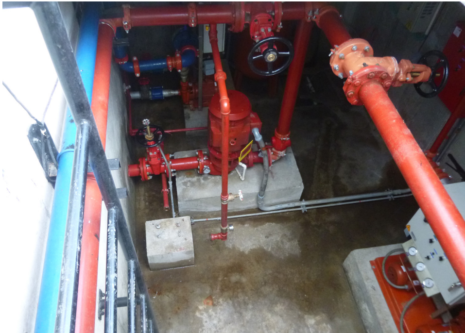
Figura 50. Cuarto de maquinaria de la planta de tratamiento, Centro Regional Buga.
