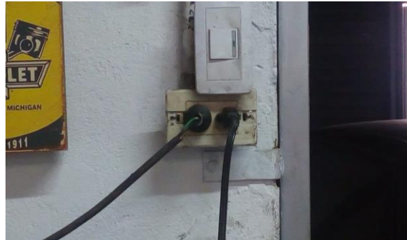
Figura 1. Peligro eléctrico A.
