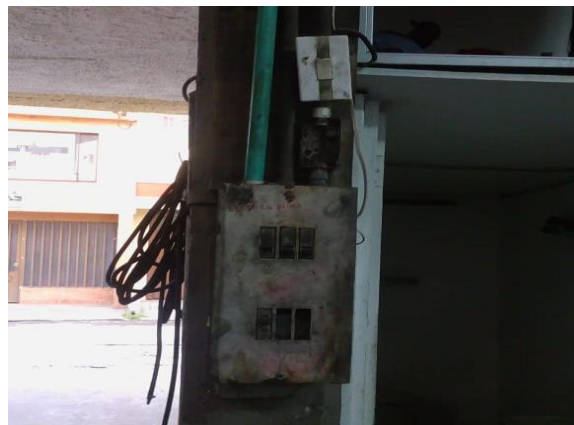
Figura 2. Peligro eléctrico B.
