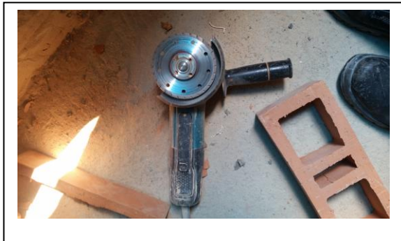
19 inspección de herramienta eléctrica
