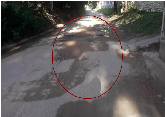
Ilustración 21 Perdida de capas
