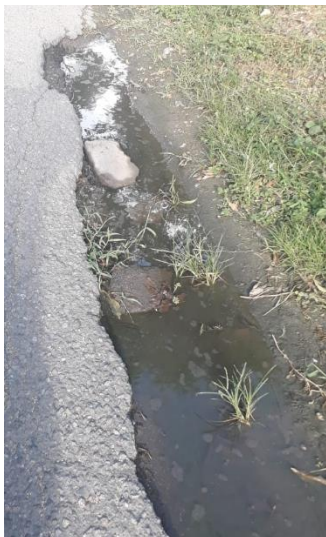
Ilustración 12 Pérdidas de capas
