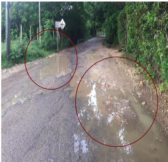
Ilustración 16 Perdida de capas
