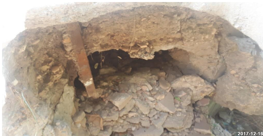
Ilustración 15 Socavación en el estribo de salida costado derecho.
