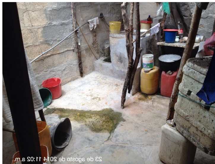
Figura 17. Vista piso con humedades y hongos
