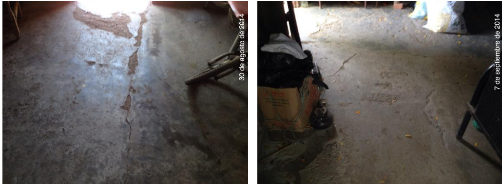
Figura 16. Vista piso deteriorado
