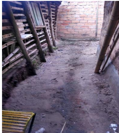
Figura 21. Vista de muros desplomados
