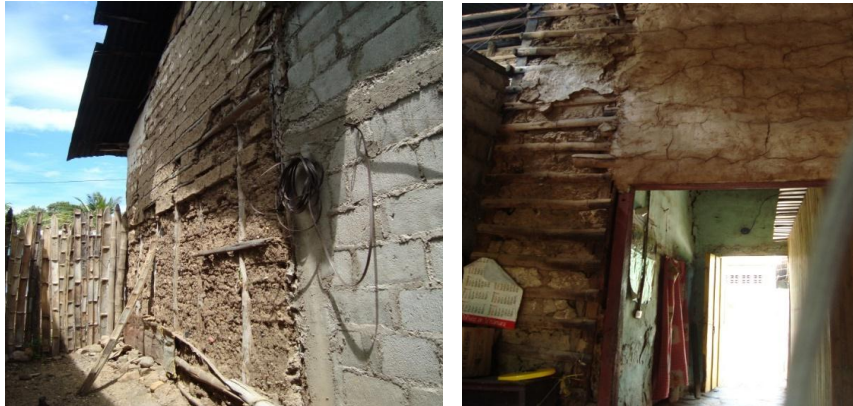
Figura 19. Vista desprendimiento de pinturas y revestimientos.
