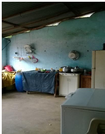
Figura 11. Cocina de la vivienda el cual no posee un mesón ni un lavaplatos.
