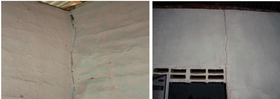
Figura 23. Vista de algunas grietas
