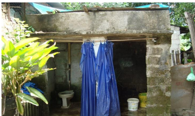
Figura 26. El baño presenta humedad en muros, además que su mobiliario es prácticamente nulo y no posee puertas.
