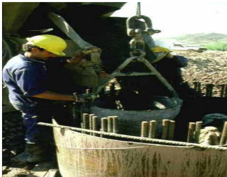
Figura 16, Pozo Empotrado, Procedimientos Constructivos, vaciado de concreto mediante el uso del tubo tremí (Hurtado, 2008)
