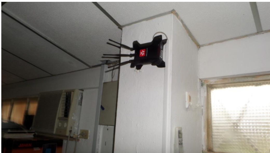
Figura 21. Router fuera de funcionamiento
