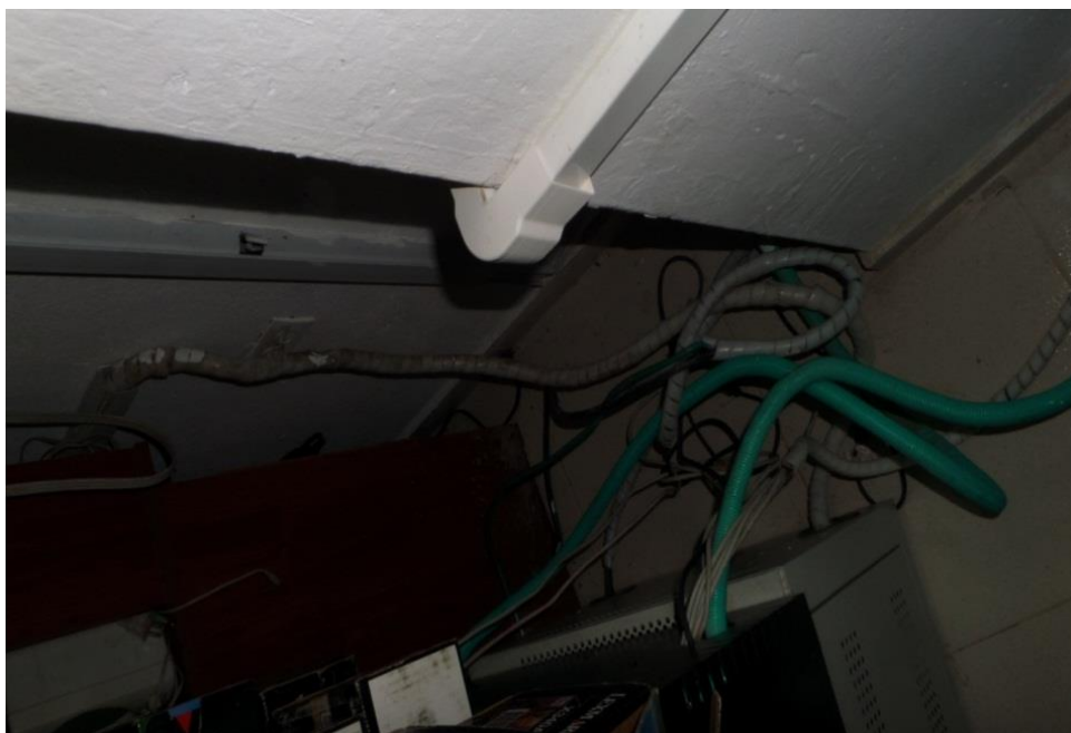
Figura 19. Sistema Eléctrico para gabinetes
