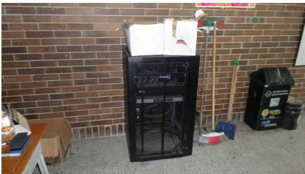
Figura 22. Gabinete de comunicaciones
