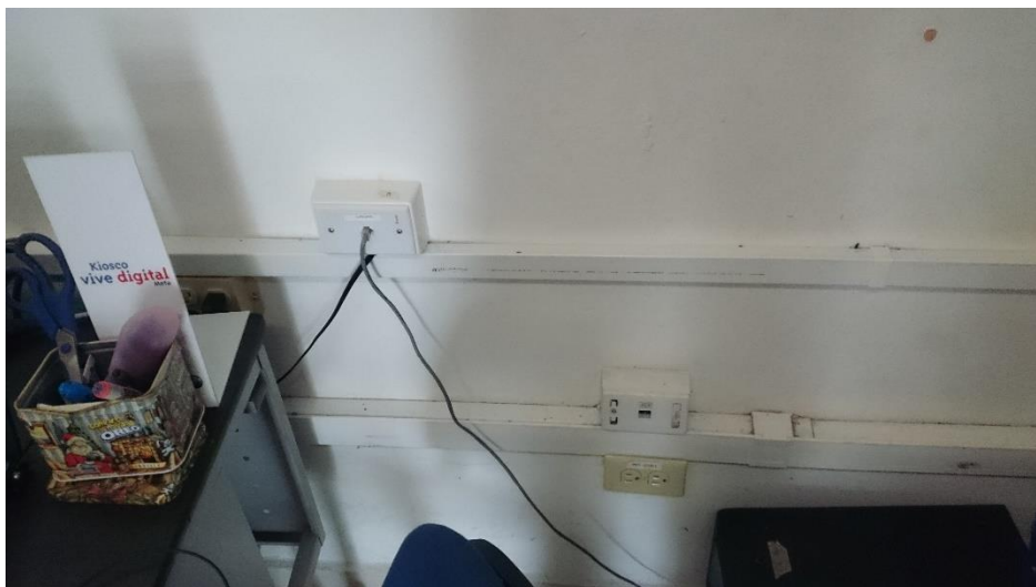
Figura 7. Conexiones de red
