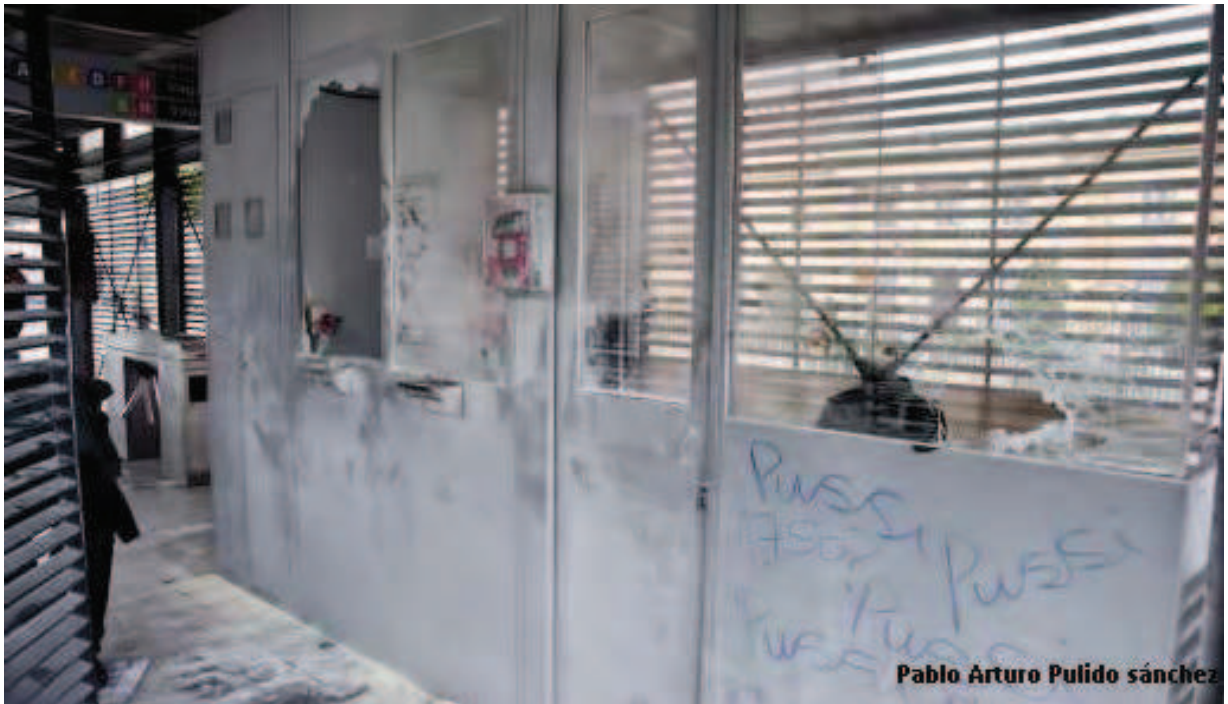
Esta estación quedó destrozada por los manifestantes que al no ver solución a sus inconformidades decidieron acabar con ella, así quieren mostrarle a los dirigentes del sistema que es necesario tomar medidas para mejorar el servicio.
