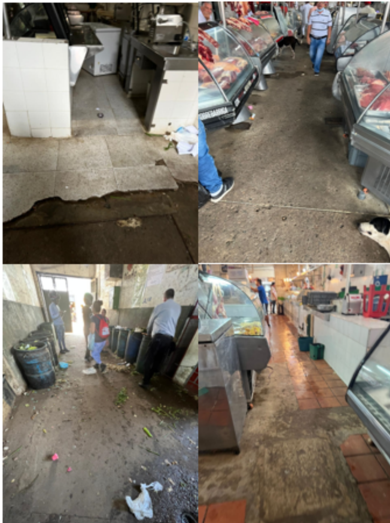
Ilustración No. 11. Estado del suelo
