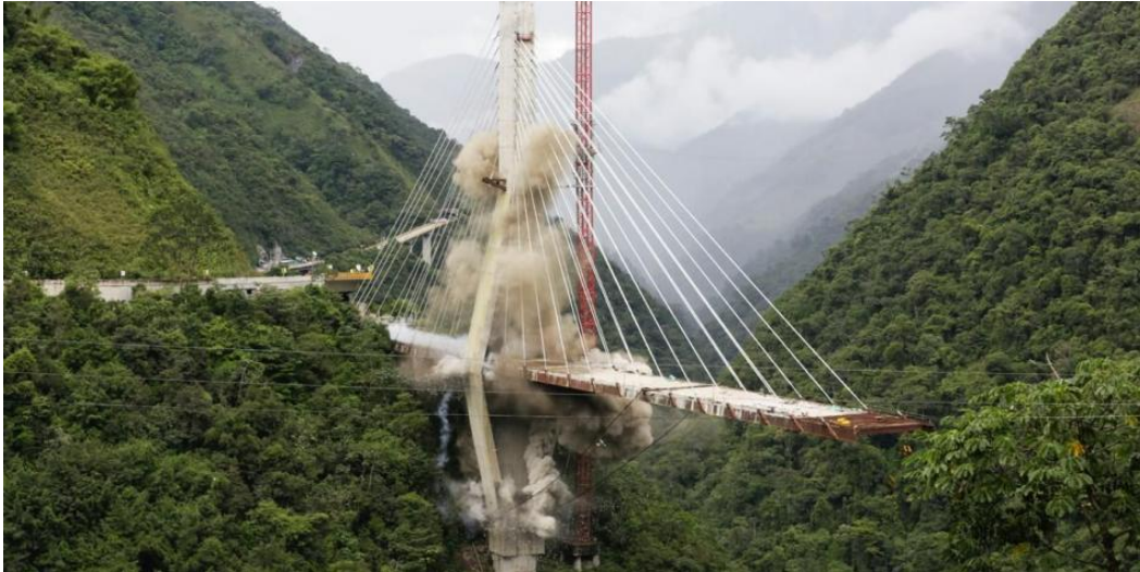
Fotografía 1. Momentos en que el puente colapsa.
