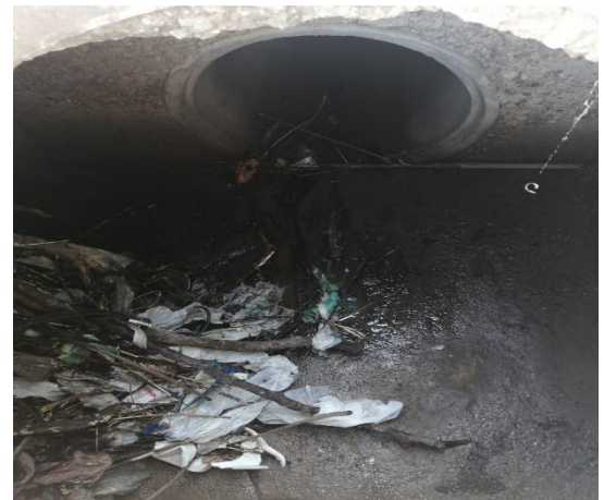
Ilustración 16 Ilustración 10 ESTADO DEL TRAMO FINAL DE LA RED DE ALCANTARILLADO FUENTE: AUTOR PROPIO
