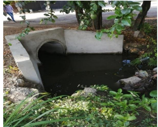
Ilustración 14 CANAL A CIELO ABIERTO FUENTE AUTOR PROPIA
