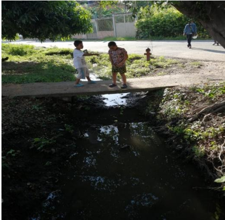
Ilustración 13 CANAL A CIELO ABIERTO FUENTE AUTOR PROPIA
