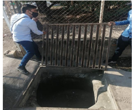
Ilustración 22 DIAGNOSTICO VISUAL DEL SUMIDERO FINAL FUENTE: AUTOR PROPIO
