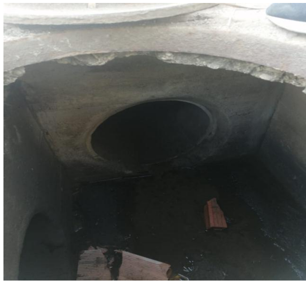
Ilustración 21 ESTADO DE LA RED DE ALCANTARILLADO FUENTE: AUTOR PROPIO
