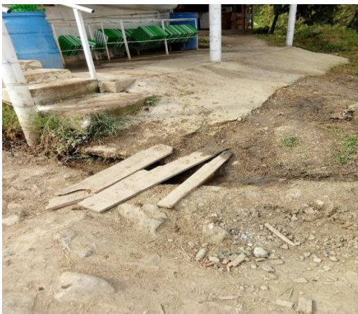
Ilustración N°4: Andenes en mal estado
