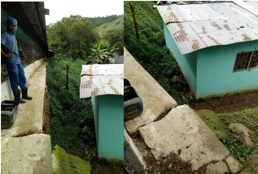
Ilustración N°2: Andenes en mal estado
