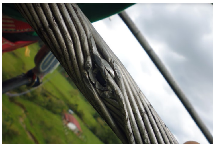
Ilustración 4 Afectación Conductor por impacto de proyectil de arma de fuego, Elaboración Propia, 2020
